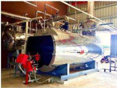
Lò hơi, lò đốt, đường ống và thiết bị áp lực
